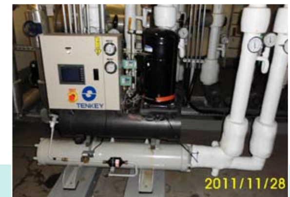
急診大樓熱泵系統
