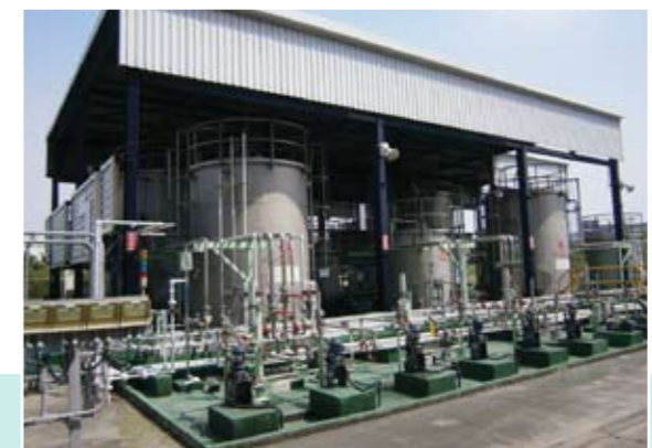
廢溶劑取代柴油作為輔助燃料(廢溶劑貯槽)
