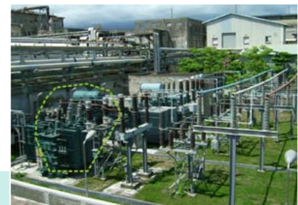
增設TR2變壓器-增加台電受電容量-停用復水式發電機
