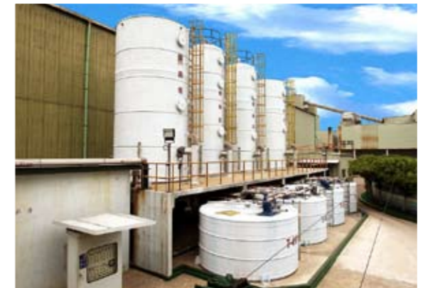
沼氣純化設備
