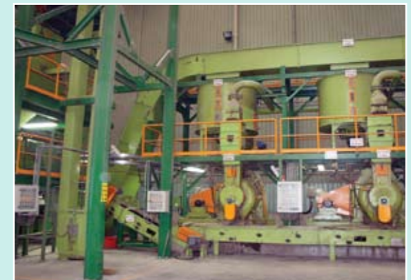
生質能(RDF-5)造粒設備
