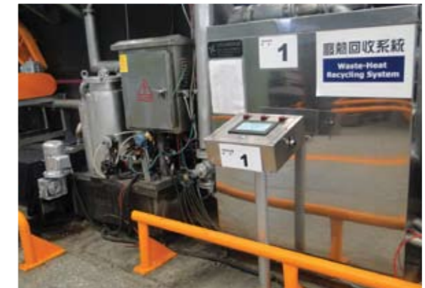
廢水熱能回收機
