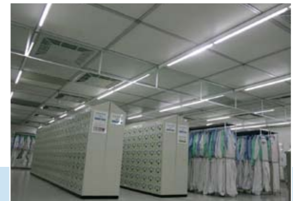
無塵室全面落實綠色LED照明
